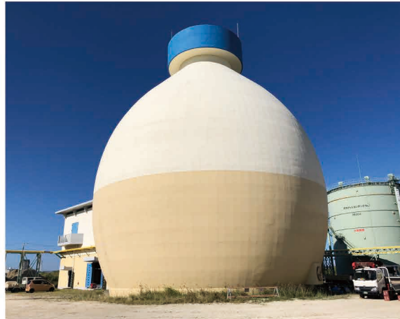
汚泥消化タンク
