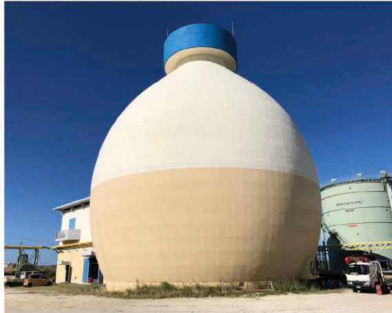
汚泥消化タンク
