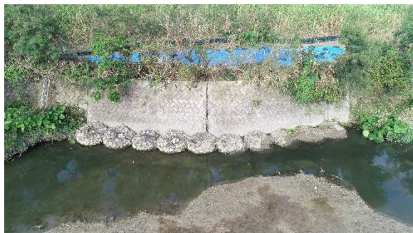
報得川 被災状況
