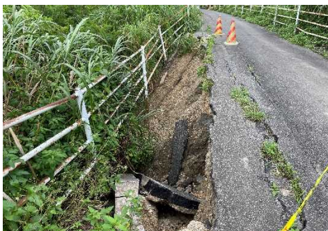
玉城那覇自転車道線 被災状況
