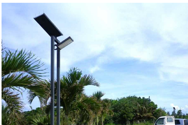
ソーラーパネル併設の屋外照明設備(中城湾港)
