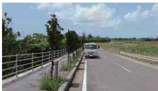
街路樹足下の雑草の繁茂
