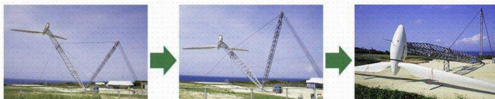
波照間可倒式風力発電設備 (傾倒時)
