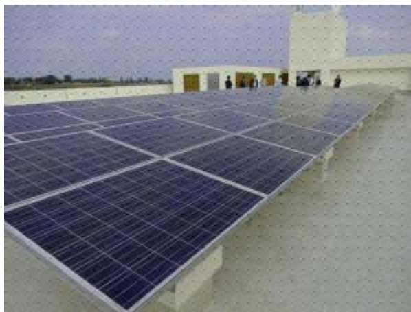
図 4-7 伊江小学校に設置された太陽光パネル
