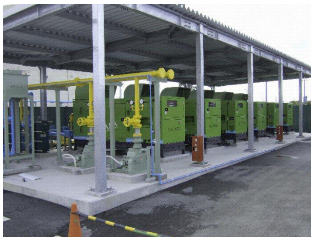
図 4-4 具志川浄化センターに導入したバイオマス発電設備
