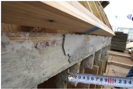
写真 10.7 型枠継ぎ目でノロが固まった状況
