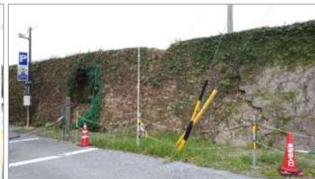
脇門と崩落箇所
