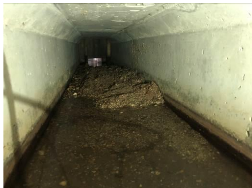
管渠内に堆積した土砂 (2/1)
