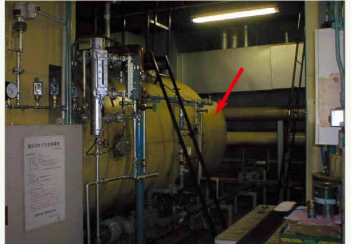
石綿含有保温材（ボイラ外周部）
