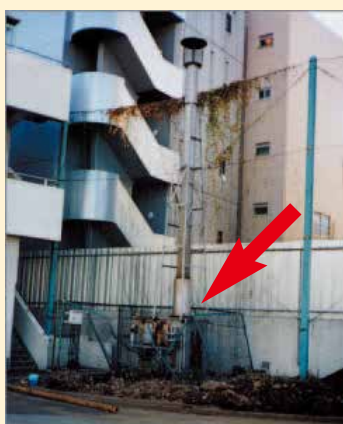
廃棄物焼却炉
