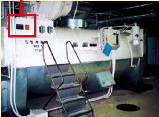
ターボ冷凍機
