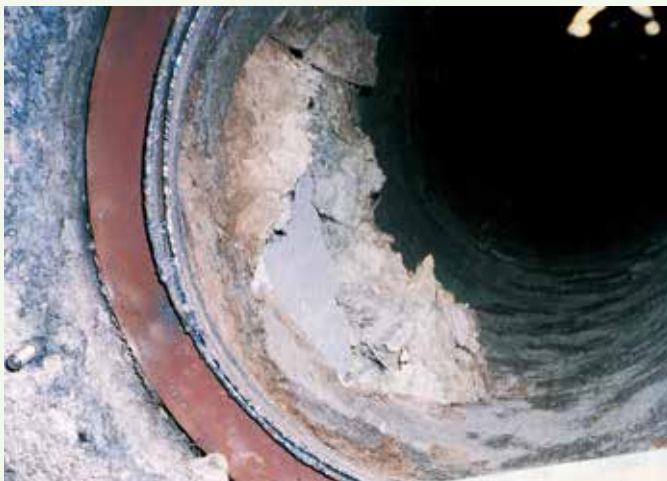
煙突断熱材（ライニング）
