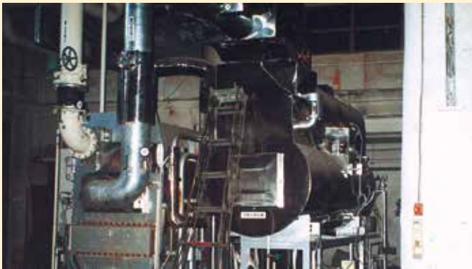
吸収式冷凍機
