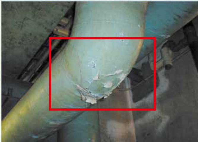
石綿含有保温材（配管曲がり部）
