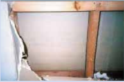
砒素・カドミ含有石膏ボード
