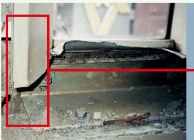
結露防止用吹付け石綿・石綿含有吹付けロックウール（カーテンウォール裏等）
